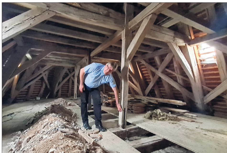
Der beschädigte Dachstuhl drückt auf das Deckengewölbe. Dadurch sind Risse im Mauerwerk des darunterliegenden Chors entstanden, erklärt Architekt Dieter Schmid.
